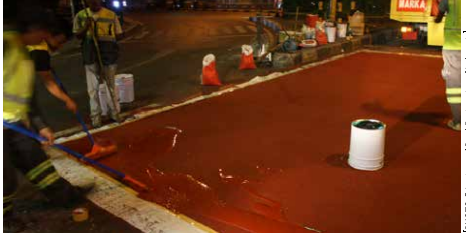
Laswi- Ahmad Yani kavşağında uzun ömürlü DEGAROUTE® MMA Soğuk Plastik işaretleme uygulaması
